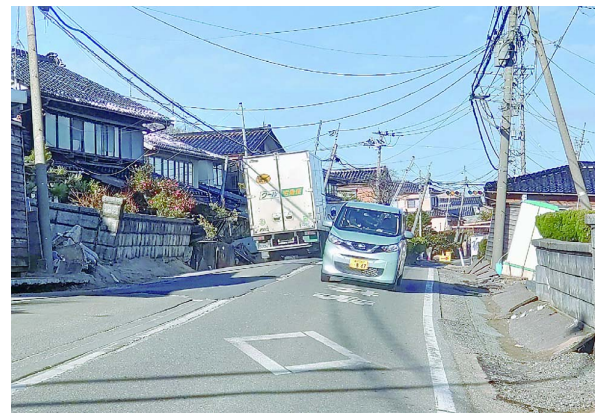
液状化で道路が隆起、沈没し、車は傾きながら走行する(17日、内灘町西荒屋地域)
