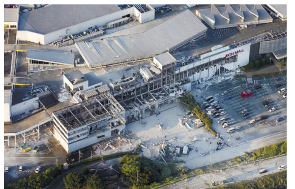
爆発で外壁などが大きく崩れたイオンモール熊本=7月28日午後6時38分、熊本県嘉島町(共同通信社ヘリから)
