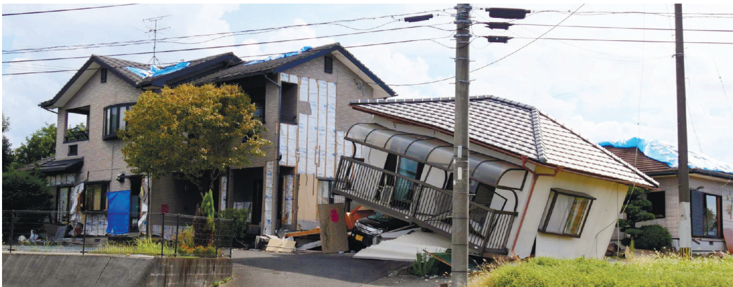
地震で倒壊した家屋。近づく台風や大雨に、雨漏りや地盤の緩みによる被害拡大を心配する声が(宇城市)
